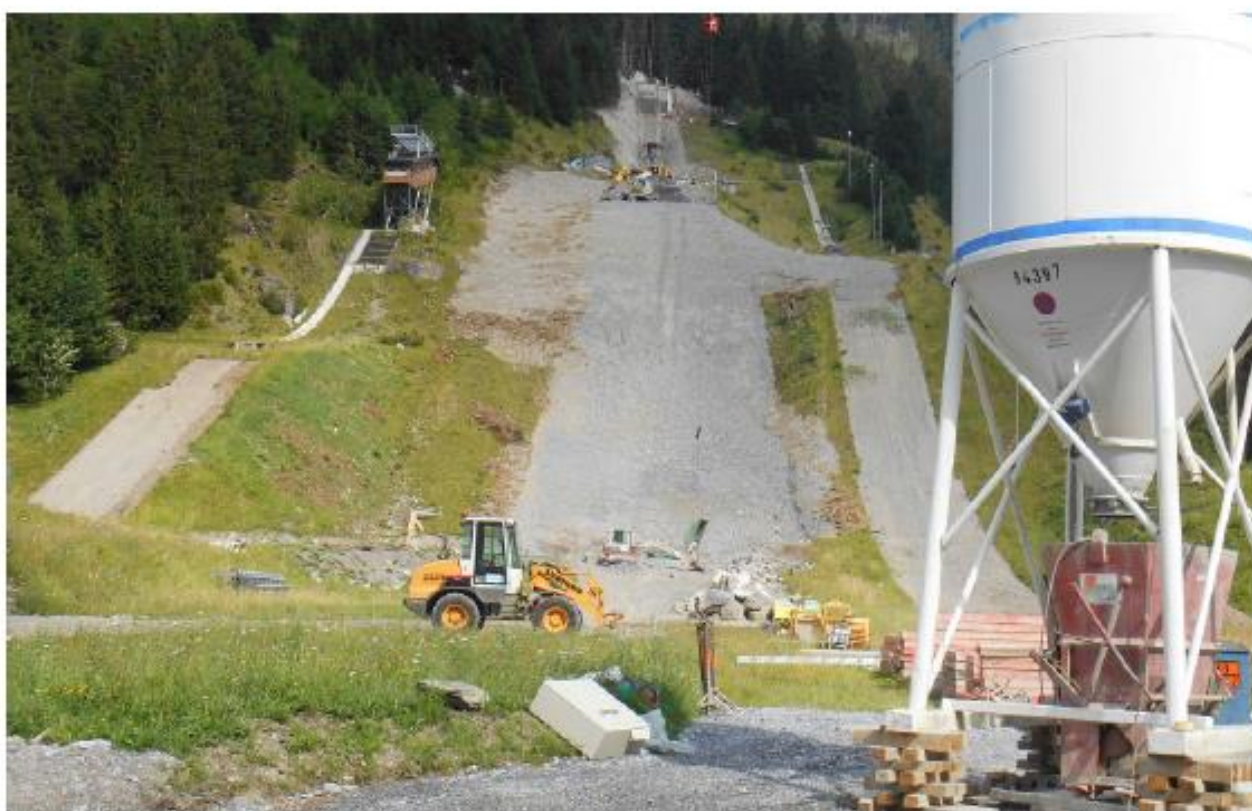
Die Baustelle in Kandersteg: In der Bildmitte entsteht die grosse neue Schanze, links und rechts sind Überreste der alten Anlage zu sehen. Hans Rudolf Schneider
